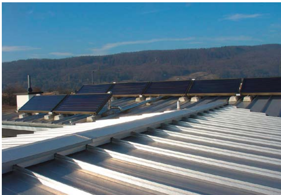
// Photovoltaik-Anlage auf dem Dach der Lagerhalle der FRITZ! GmbH
